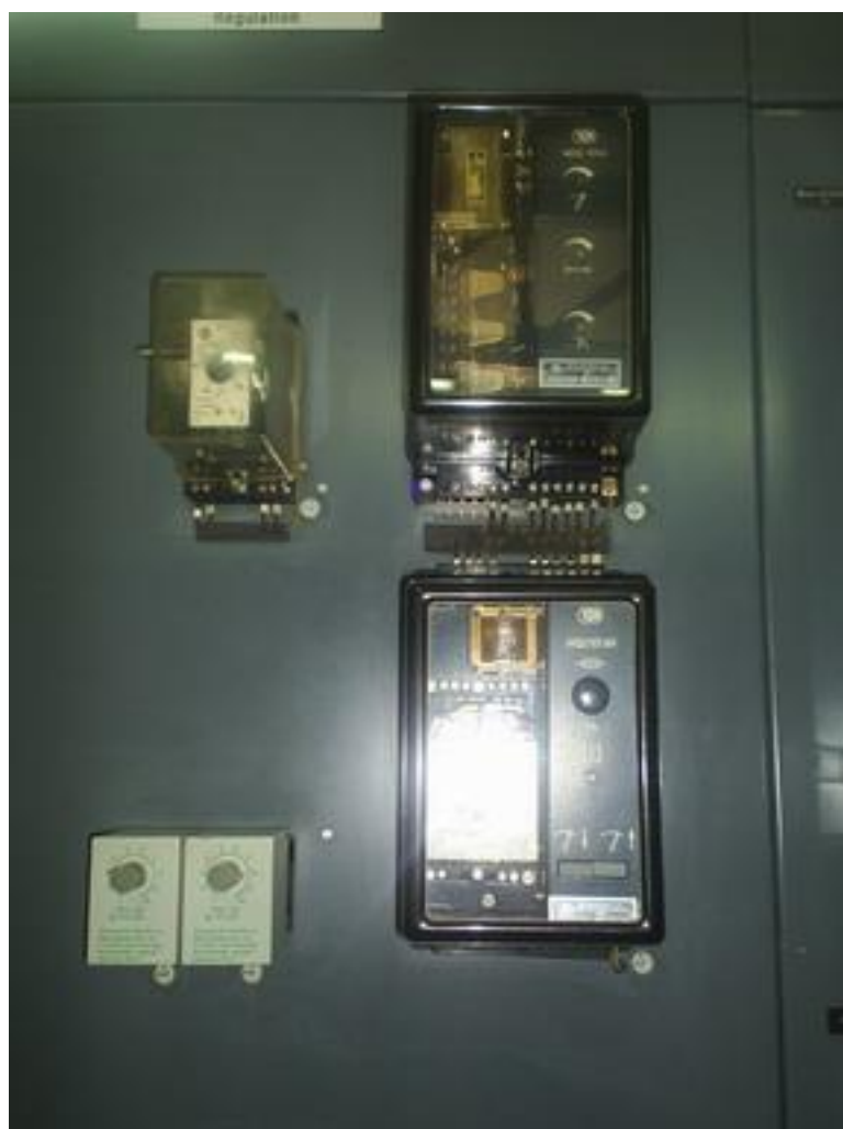
تابلو رله های حفاظتی خازن
