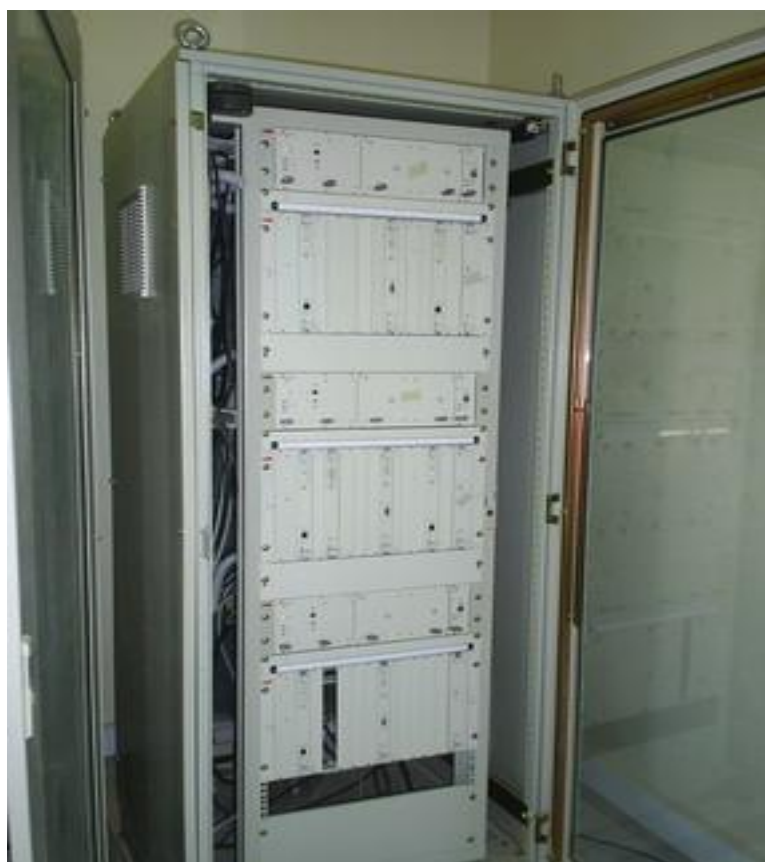
نمای کلی کابینت PLC ایستگاه صدرا
