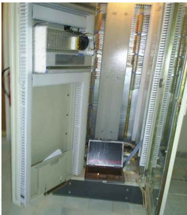
نمای داخلی RTU (ایستگاه ۲۳۰ صدرا)
