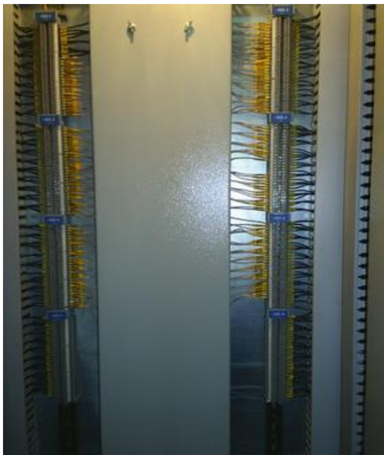
ترمینالهای داخل RTU
