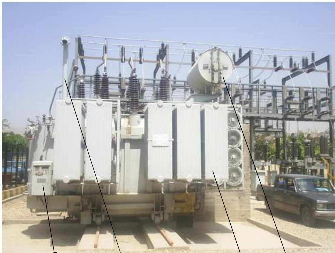
تابلو مکانیزم تپ چنجر
