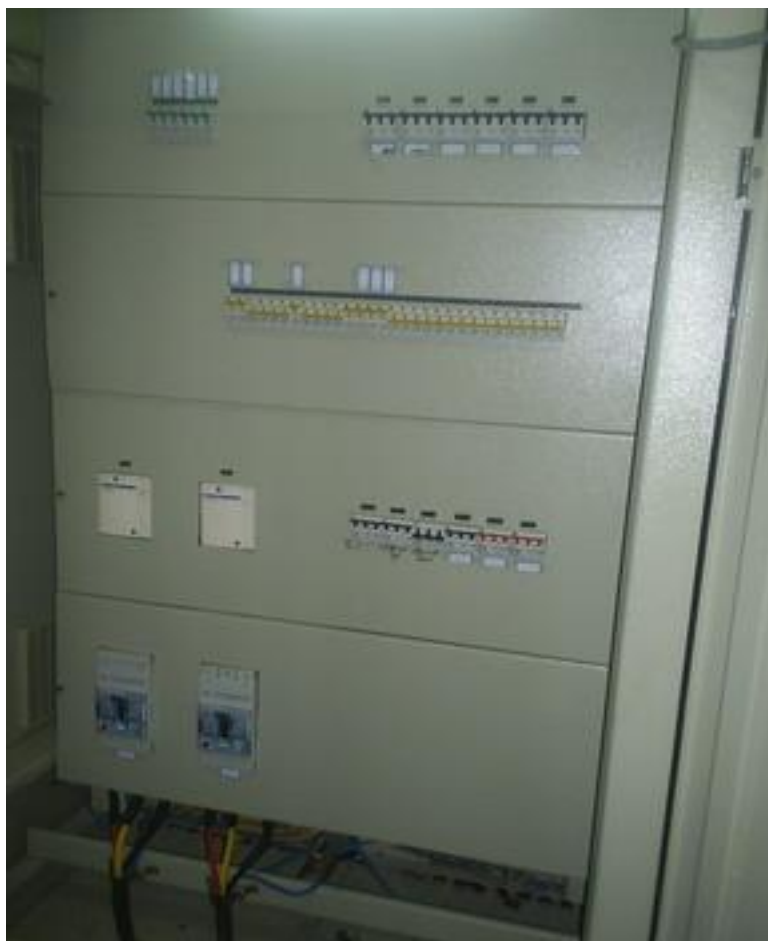
تابلو کلیدهای ترانس توزیع داخلی
