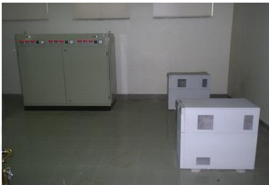
UPS و تابلو توزیع برق
