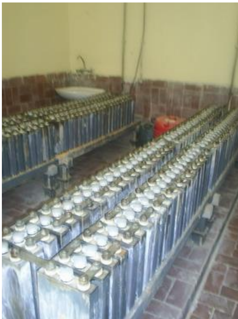
باتری های تغذیه DC ایستگاه (باتری خانه ایستگاه)
