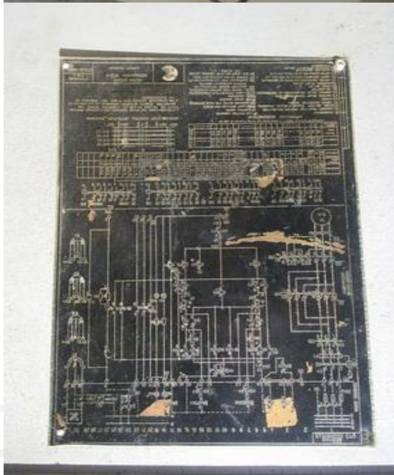
تابلو داخلی تپ چنجر
