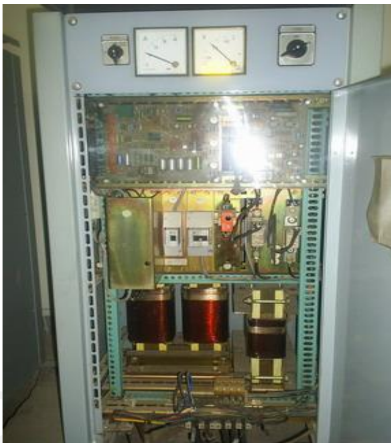
شارژر باتری خانه ایستگاه
