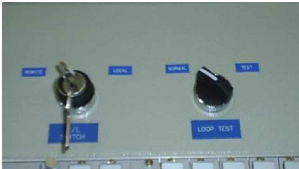
کلیدهای Remote/Local و Loop Test
