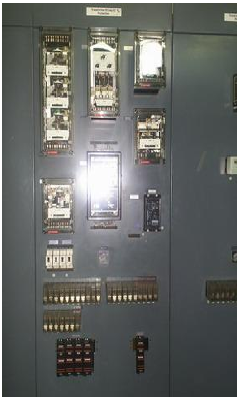
تابلوی رله های حفاظتی ترانسفورماتور
