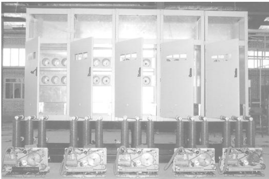
شکل (۲): بدنه تابلوی فلزی ۵ سلول یک پارچه
